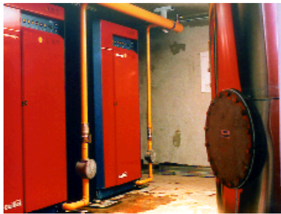
La chaufferie - photo O. SEBART
