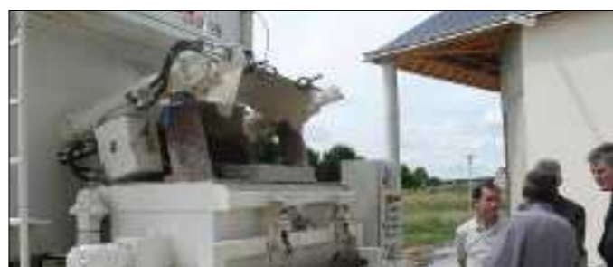
La Mobil'chape en action à Saint-Roch où l'on construit le groupe scolaire.
