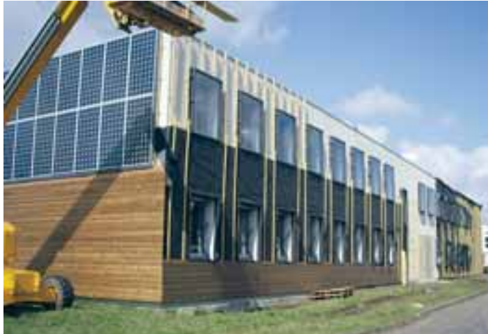
En combinant plusieurs technologies, le bâtiment rénové est passé de la classe D, la plus énergivore, à la classe A, la plus économe.
